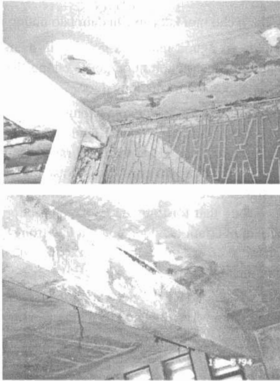
Hình 5.13. Sàn BTCT bị thấm do nứt
