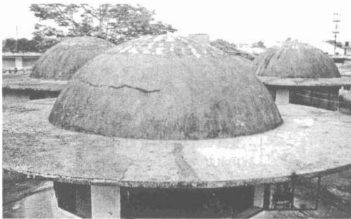
Hình 4.18. Các vết nứt kết cấu BTCT dưới tác động của khí hậu nóng ẩm
